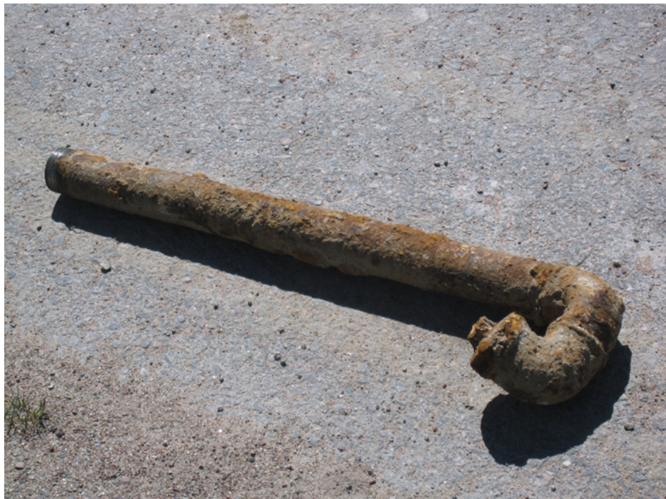
Exempel på korrosionsskada på en rördel som använts för brandfarlig vätska. Foto: MSB.
