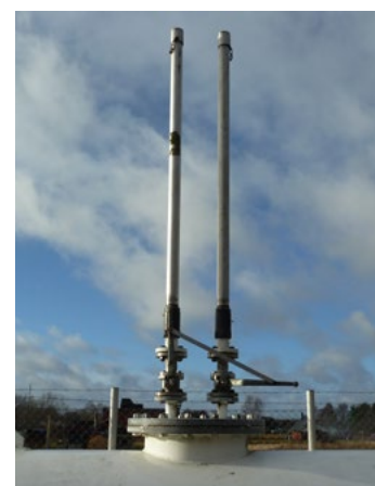
Figur 3. Säkerhetsventiler med avblåsningsrör på gasolcistern. Foto: MSB.
